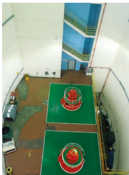
Unit hall of HPP Centroamérica
