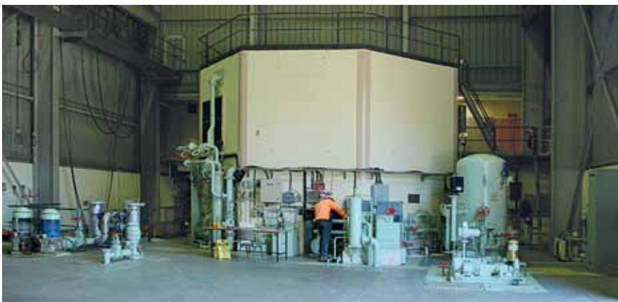
▼ Вид старого генератора на ГЭС «Fisher»
