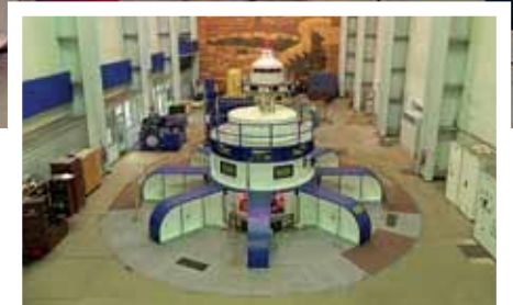
▲ Агрегаты 1 и 2 на ГЭС «Иовская»
